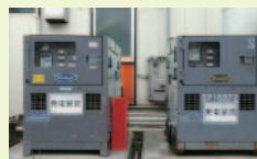
新たに設置した発電機
