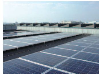
加古川事業所の屋上に並んだ太陽光パネル
