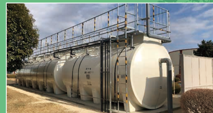
足利工場の新浄化槽
