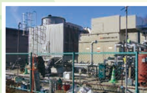
高効率設備への切り替え
