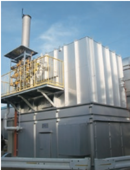
VOC無害化处理装置
