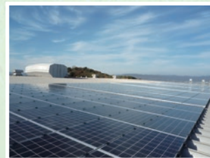
本格導入の起点となった和歌山事業所の太陽光発電システム(2011年1月)
