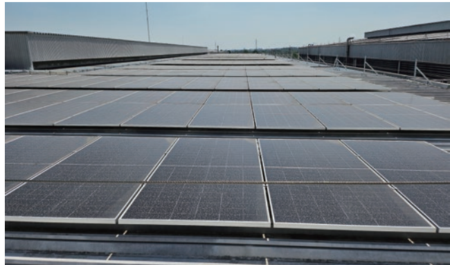
Bando Manufacturing (Thailand) Ltd. (タイ) 2024年12月増設
